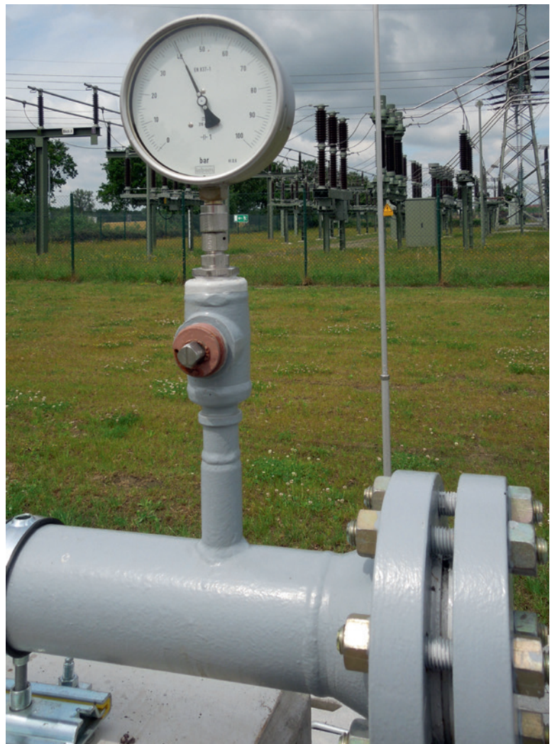
Abb. 3: Anschluss für eine mobile Molchstation an der Wasserstoffpipeline in Falkenhagen
