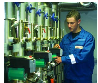
Warten einer Hausübergabestation
